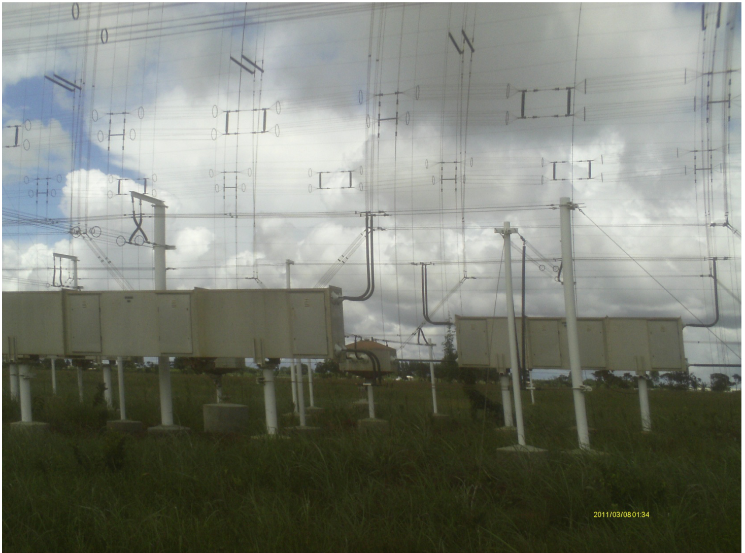
Foto 5: Vista parcial do radiador A2
