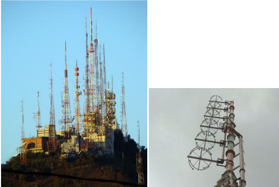
Figura 7 – Centro de transmissão da Itatiaia: visão global da estação (esq); antena FM (dir)
