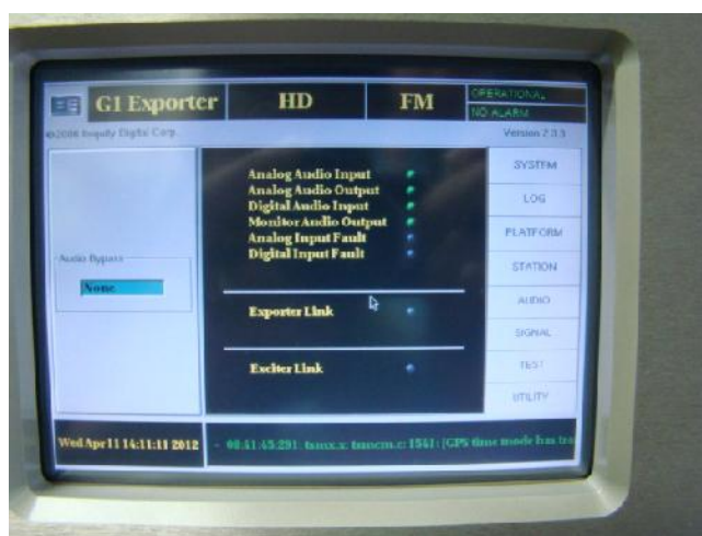
Figura 4 – Detalhe da tela do transmissor
