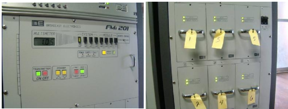
Figura 5 – Detalhes do transmissor IBOC (esq) e amplificadores (dir)
